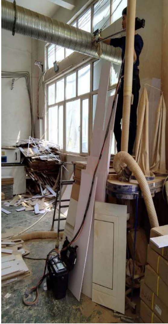
袋式除尘器及配套减噪措施
