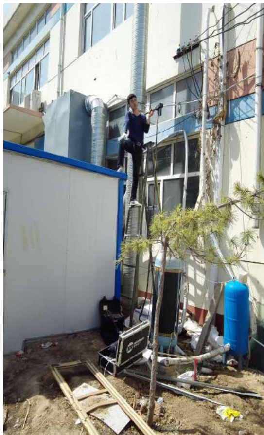
除尘器及配套减噪措施
